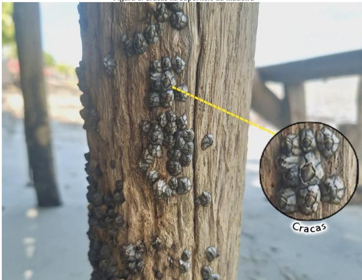
Figura 1. Cracas na superfície da madeira
